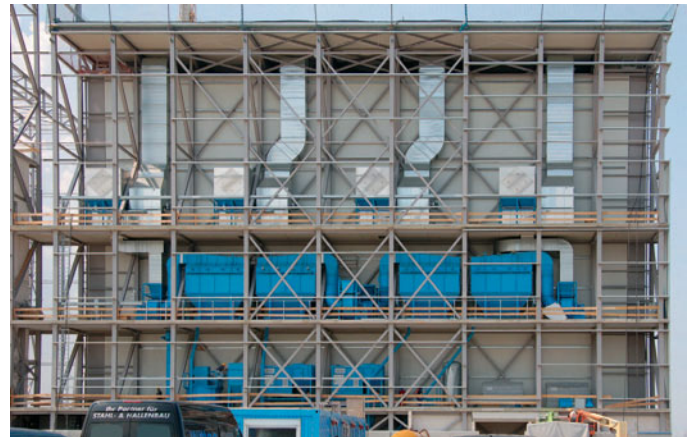
Kombinierte Strahl- und Beschichtungstechnik für Großkomponenten, auf mehreren Etagen montiert.
