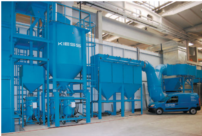
Seitlich angesetzte Maschinenteknik einer Großstrahlhalle für Windkrafttürme.
