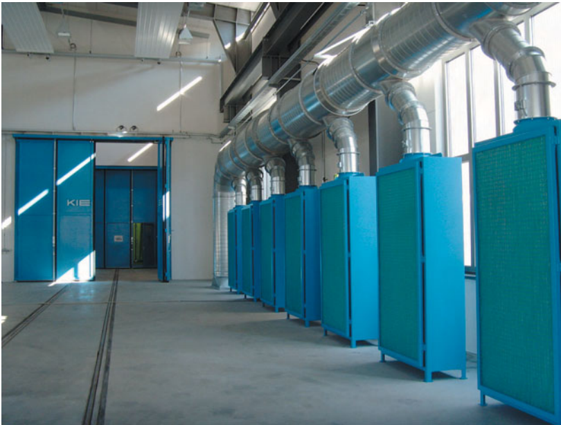
Farbnebelerfassung über Absaugwände mit Sammelleitung.
