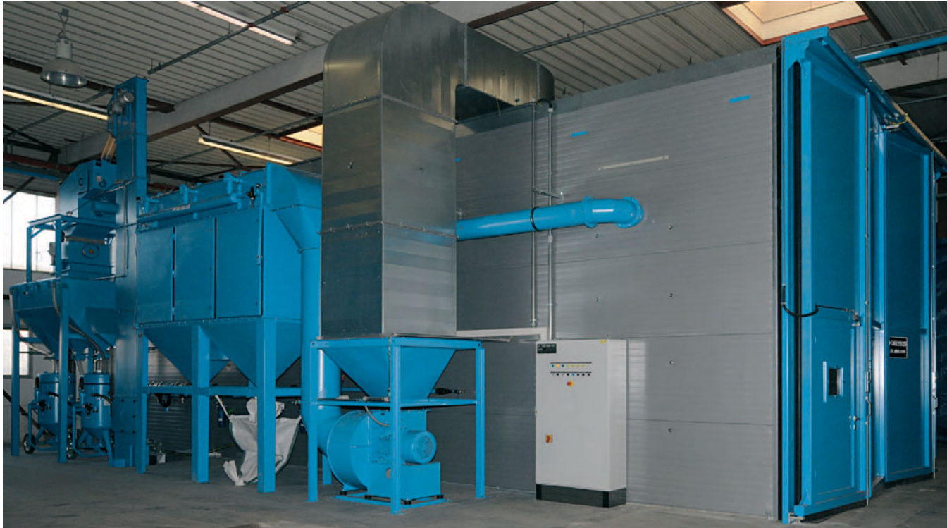
Strahlhalle mit seitlich angeordneter Maschinenteknik, bestehend aus: Becherwerk, Strahlmittelreiniger, Magnetabscheider, Silo mit zwei Strahlkesseln, Patronenfilteranlage mit Ventilator, Umluftleitung und zentralem Schaltschrank.
