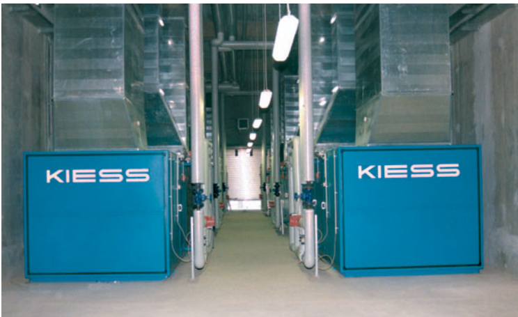
Kombinierte Lüftungsgeräte einer Beschichtungshalle mit Warmwasserbeheizung.
