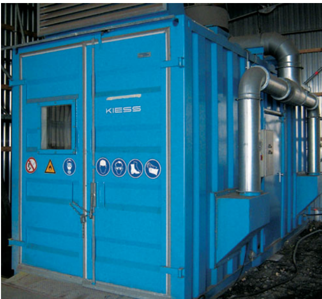
Beschichtungscontainer mit seitlicher Absaugung und zentralem Dachventilator.
